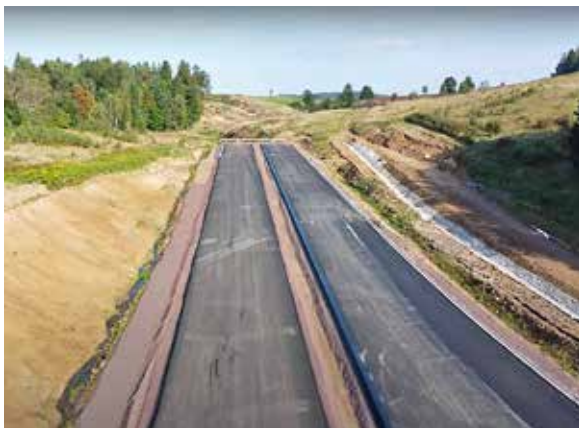
Fot. 2. Zniszczone siedlisko szablaka przepasanego Sympetrum pedemontanum w Ptaseku, w wyniku budowy drogi ekspresowej S3, 09.2021 (fot. domena publiczna).
