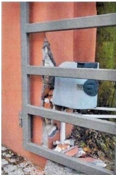
Ryc. 1. Uszkodzony mechanizm automatycznego zamykania bramy na posesję Muzeum.
