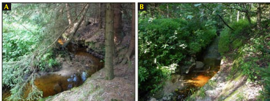
Ryc. 15. Dolny odcinek koryta Bobrówki: A – odsyp meandrowy na jednym z zakoli; B – fragmenty zniszczonych ubezpieczeń brzegowych w formie murów oporowych.
