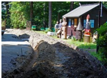
Ryc. 2. Rozkopana droga dojazdowa na posesję Muzeum Przyrodniczego w Parku Norweskim podczas rewitalizacji parku, utrudniała przeprowadzkę instytucji do nowej siedziby (fot. S. Firsz).
