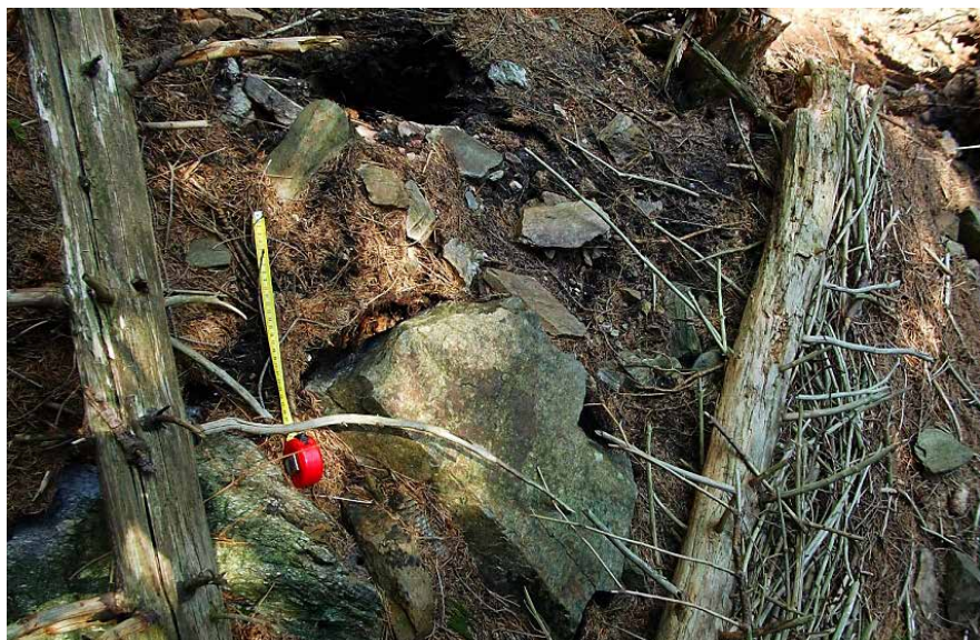
Fot. 3. Szczyliny tensyjne (z rozciągania) w pokrywach stokowych w pobliżu osuwiska na Średniaku (fot. K. Parzóch).
